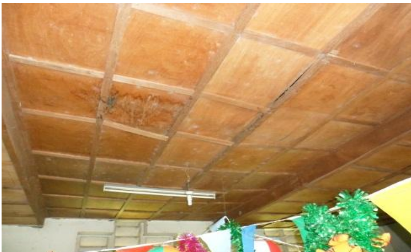
DETALLE DEL ESTADO DEL TECHO DE LA CAPILLA DEL SEMINARIO MENOR
